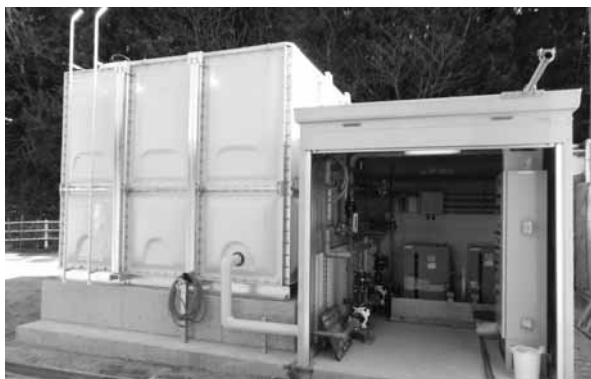
新しいヒ素除去装置
